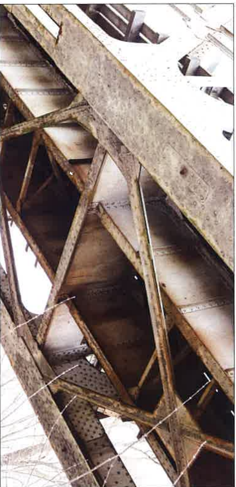
Pas dolny dźwigarów z widocznymi podłużnicami i poprzecznicami usztywnionymi krzyżakami. (fot. Jakub Andrzejewski, 2021 r.)
