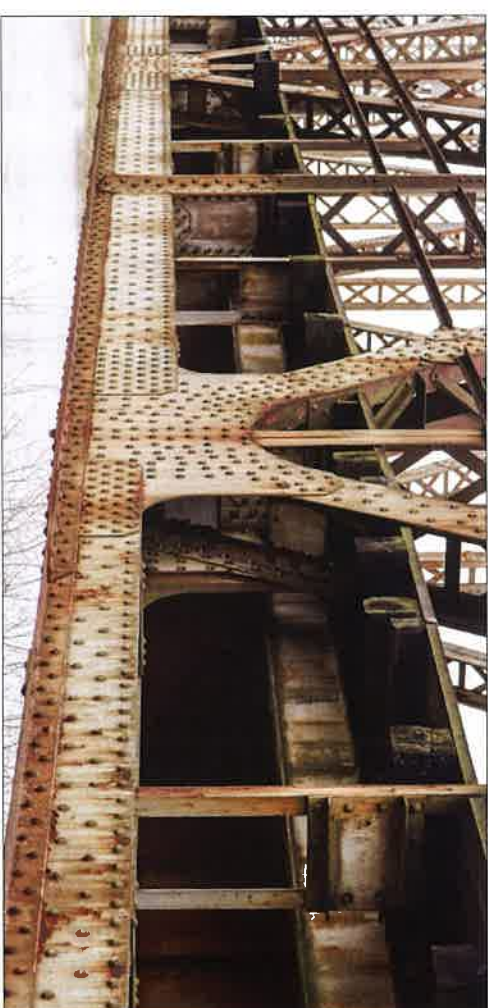
Pas dolny kratownicy dźwigara od strony północnej z widocznymi drewnianymi mostownicami i pomostem. (fot. Jakub Andrzejewski, 2021 r.)
