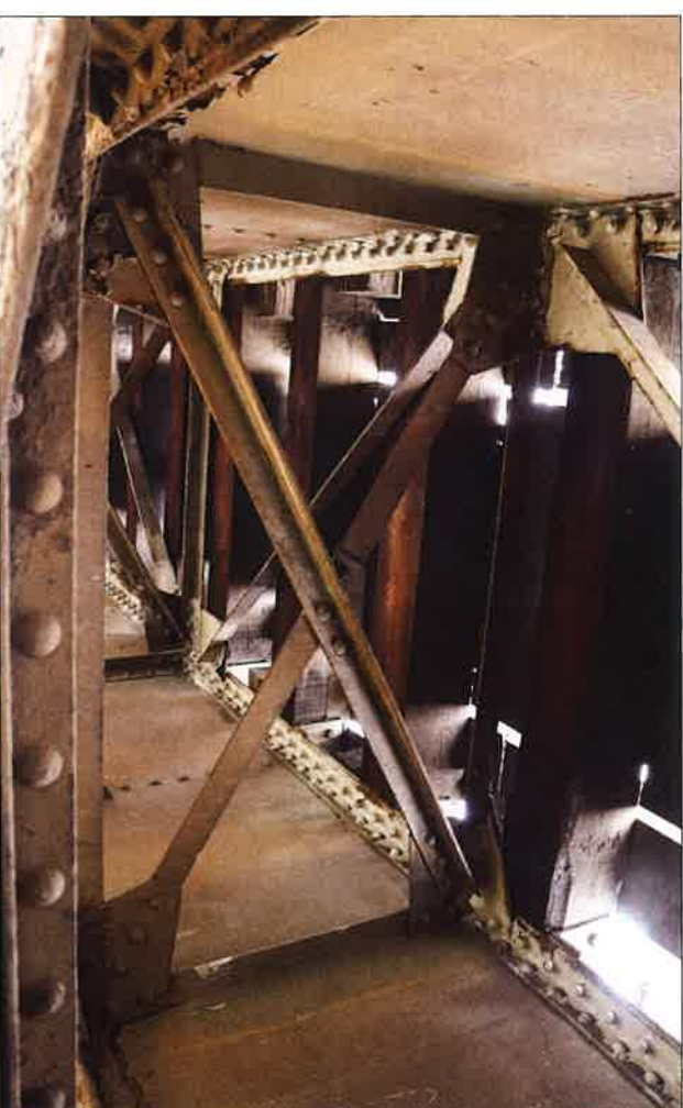
Krzyżulce usztywniające podłużnice i konstrukcję części jezdnej mostu. Powyżej widoczne drewniane mostownice (podkłady). (fot. Jakub Andrzejewski, 2021 r.)
