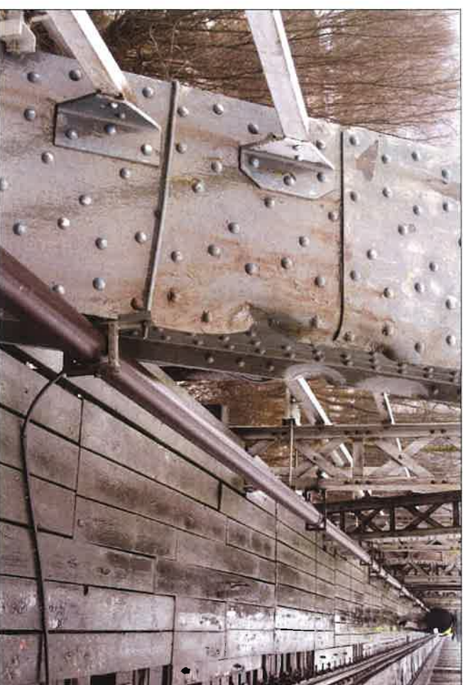
Widoczne uszkodzenia słupa w siódmym dźwigarze spowodowane przez przesunięcie ładunku na wagonie. (fot. PKP PLK Zakład Linii Kolejowych w Siedlcach 2014 r.)
